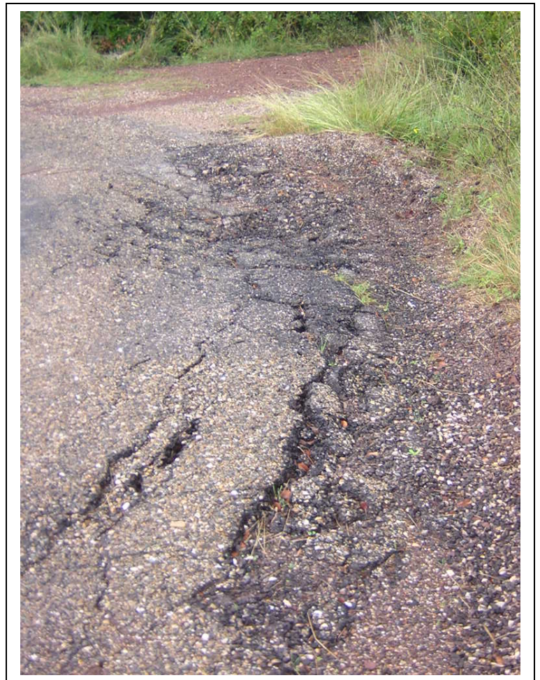
Figure 2 : Déformation de la chaussée et des talus au sein des pélites permienes dans le secteur de la Plaine
