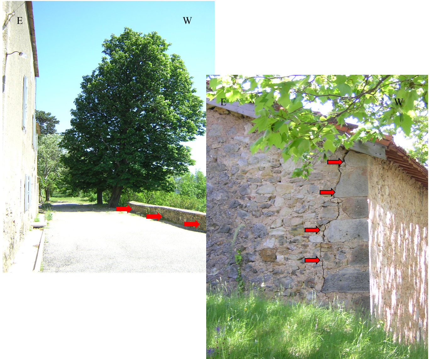
Figure 7 : Manifestation d'un glissement de versant à mouvement lent : désordres sur chemin et fissuration d'une bâtisse au hameau de la Défriche montrant un mouvement d'ensemble vers l'Ouest
